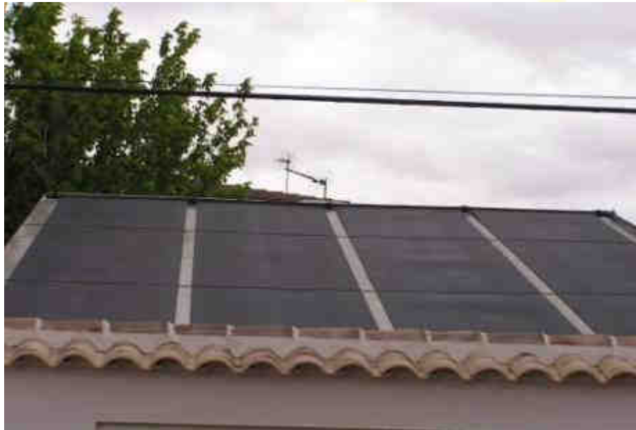
Climatización de piscina descubierta con colectores de polipropileno
